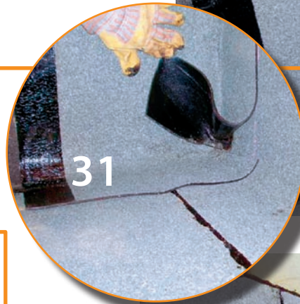
31 Auspringende Ecke Gegenseite: Quetschfalte bis in die Ecke einschneiden. Überschüssiges Material heraus schneiden (45° auf Bahnende). Unterer Teil bis zur Quetschfalte verschweissen: gut andrücken, keine Hohlstellen zulassen.
